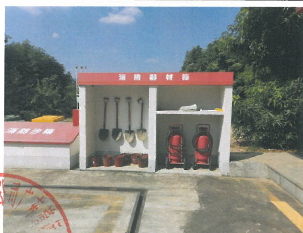
罐区消防设施
