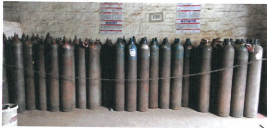
加防倾倒措施后的整改图片
