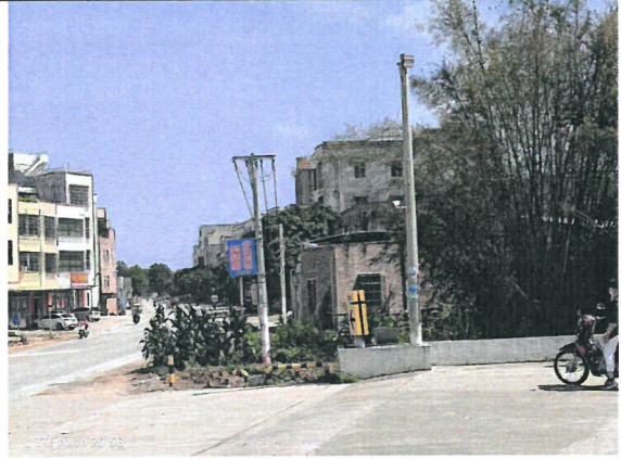
东北面的电力线
