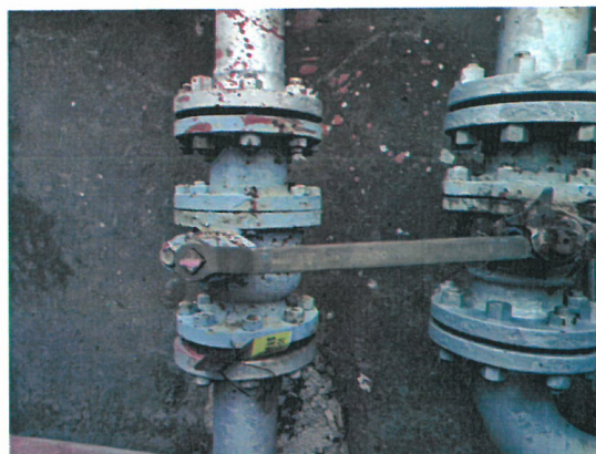
油库通过管道供油给油站的阀门
